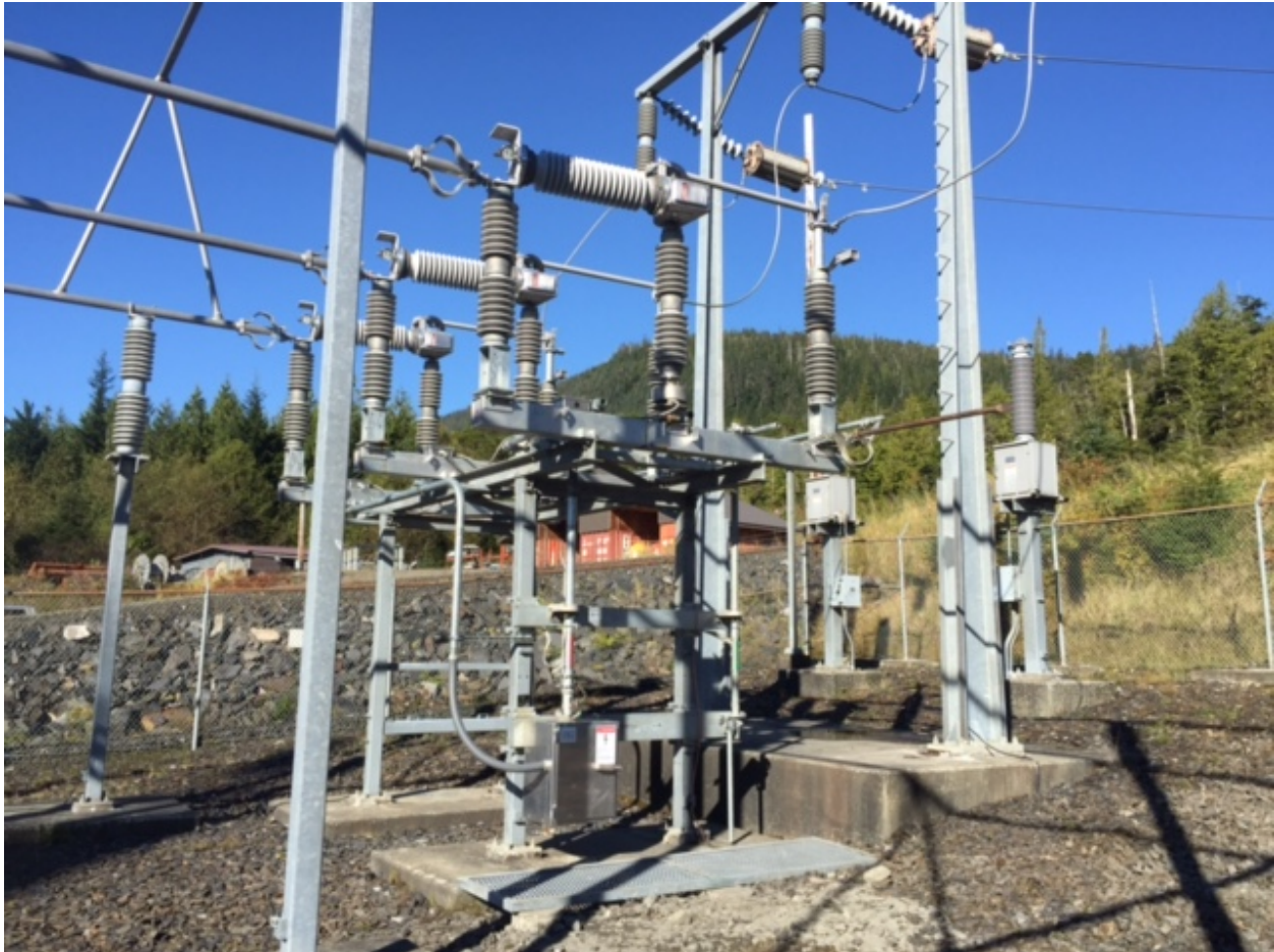
CS-T36 New Circuit Switcher
